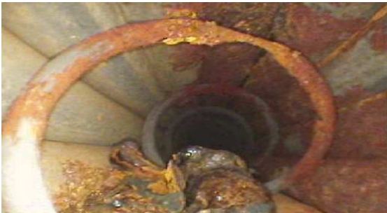
Nombreux câbles corrodés
