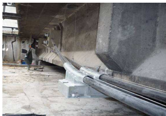
Déviateurs des câbles de précontrainte longitudinale
