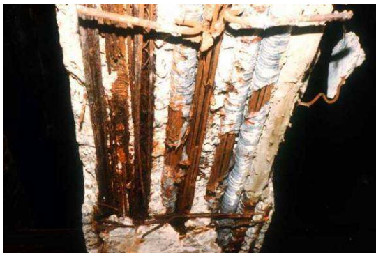
Corrosion généralisée de câbles
