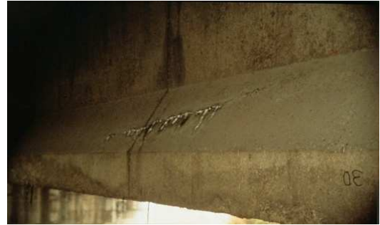
Venue d'eau active dans une fissure en talon de poutre
