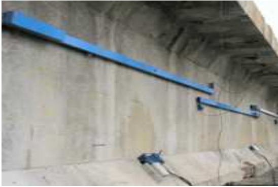
Courburemètres en place sur une poutre de VIPP
