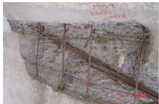
Exemple de fils rompus par corrosion sous contrainte
