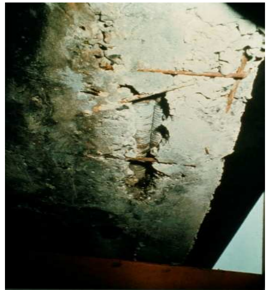
Défaut typique sous un talon de poutre dû à des difficultés de bétonnage
