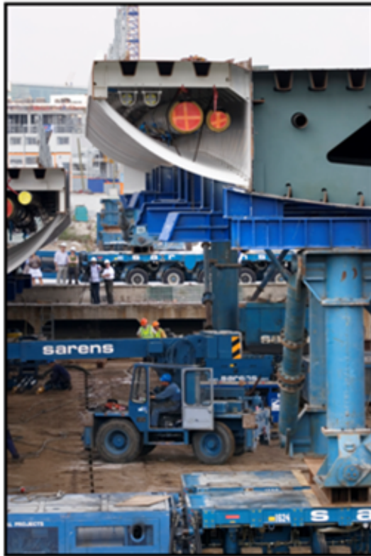
Photo 5 : Réseaux embarqués sous le tablier
