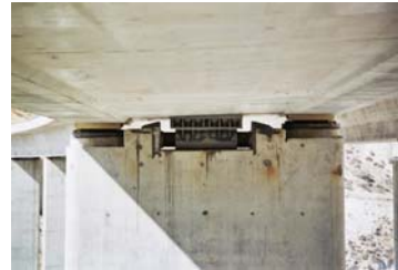
Photo 1 : Amortisseurs précontraints transversaux montés sur un pont à Petra Tou Roumiou (Chypre) selon la même disposition que celle proposée pour P2 et P4 / Pre-stressed transverse dampers mounted on a bridge at Petra Tou Roumiou (Cyprus) in the same configuration as the one proposed for P2 and P4
