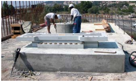
Photo 5 : Butée transversale disposée sur la culée C0 / Transverse steel stopper located on abutment C0
