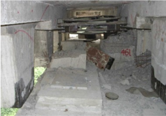
Fig 3. Poutres « pendant » à l'extérieur des têtes de piles et posant un problème majeur pour la conception des dispositifs de levage
