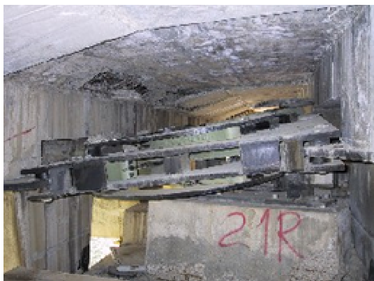
Fig 2. Dispositifs parasismiques endommagés par le séisme / Anti-seismic devices ruined by the earthquake
