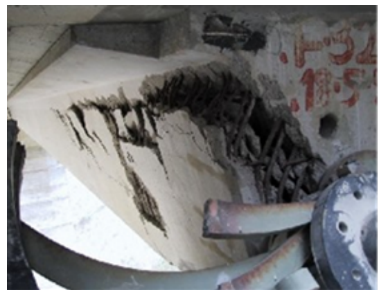
Fig 2. Severely damaged beam end Extrémité de poutre gravement endommagée
