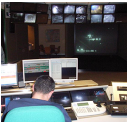
Ecrans de surveillance des autoroutes ESCOTA
