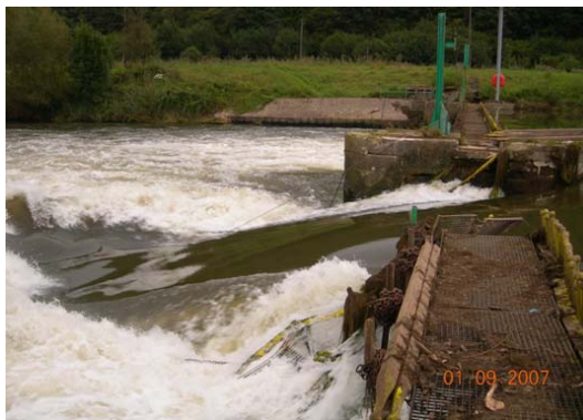
Rupture sur ouvrage
