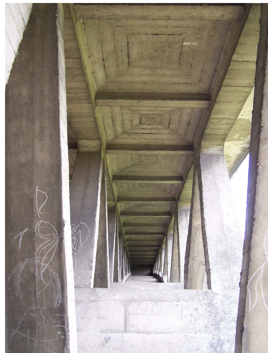
Pont Boutiron : Vue générale, détails d'exécution et état du béton vieux de près d'un siècle
