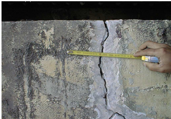
Fissuration de 4 à 5 mm sur le sommier du pylône rive gauche, avant renforcement
