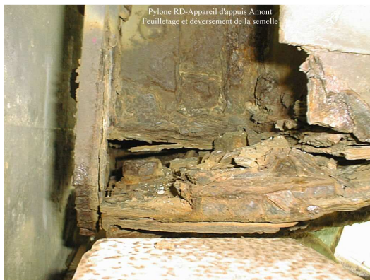
État des poutres métalliques sur l'appareil d'appui RD amont
