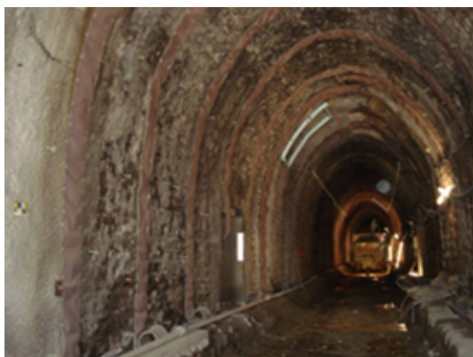
Tunnel de Racouze (1700ml) : Drainage, rescindements, niches, BP
