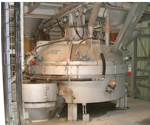
Le malaxeur du site de préfabrication à Romagnieu
