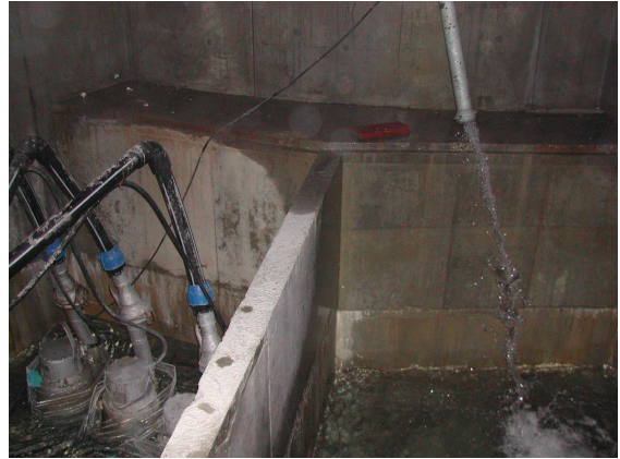
Bacs de relevage des eaux
