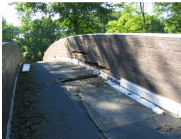
Photo 2 - Dégradation fongique sur bois lamellé collé
