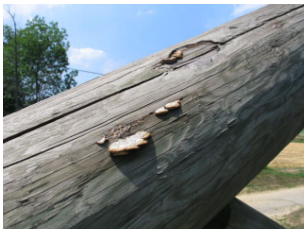
Photo 1 - Dégradation fongique sur bois traité
