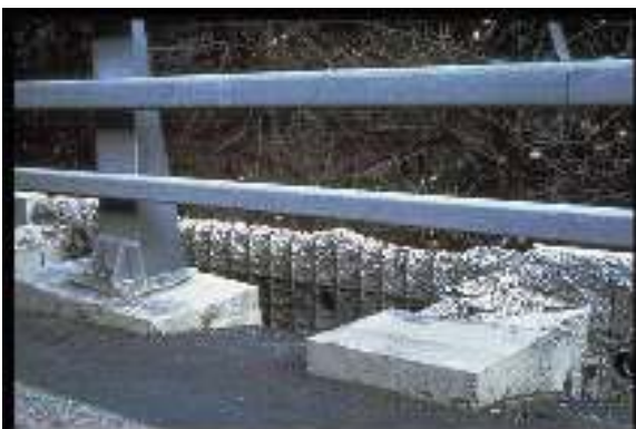
Photo 1 Gel interne d'un élément de corniche
