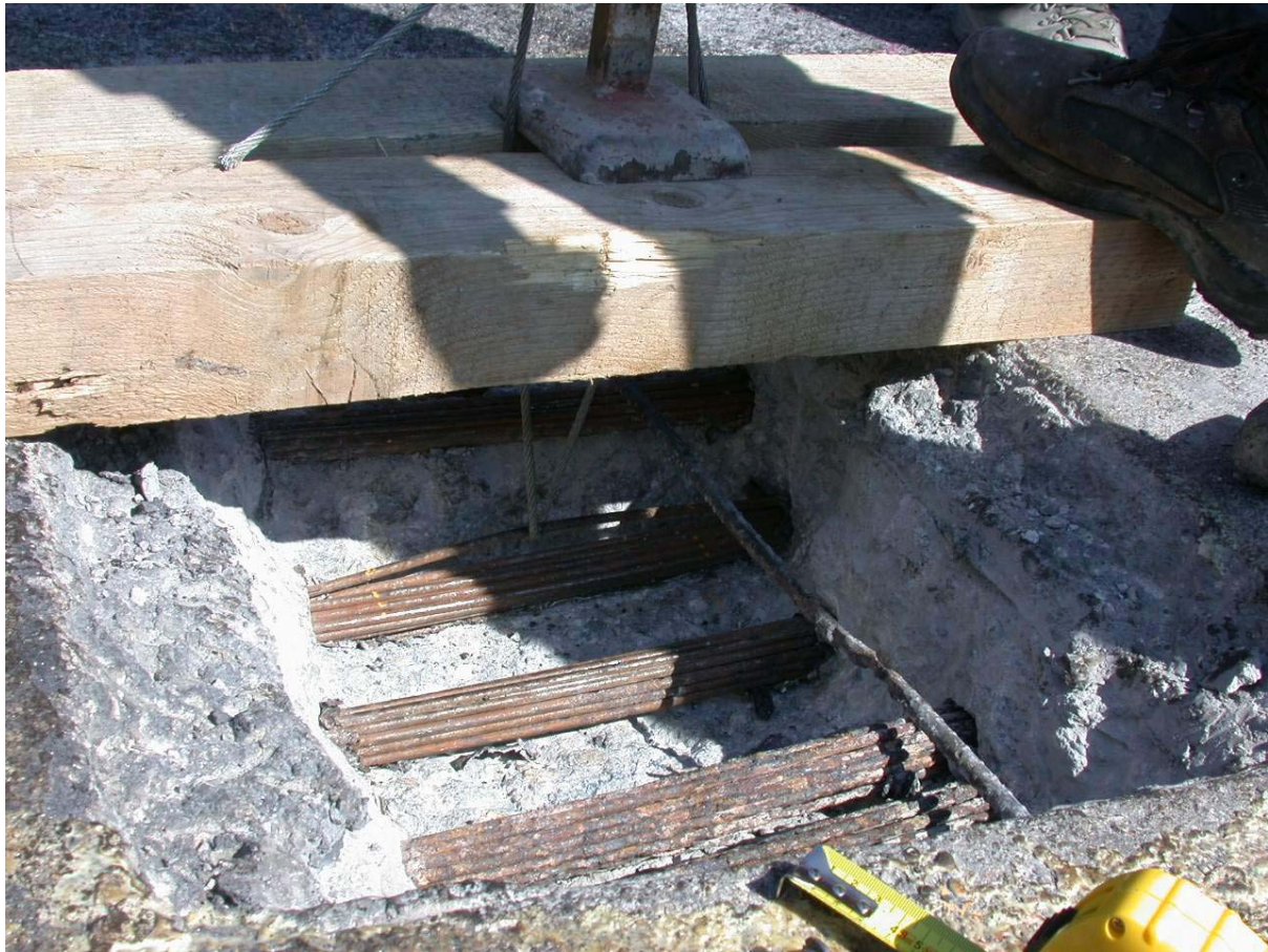
Figure 9 - Etat de la précontrainte après ouverture d'une fenêtre d'investigation suite à une rupture spontanée. Les câbles sont vides de coulis
