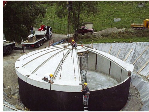
Figure 3 : Réservoir de stockage d'eau potable
