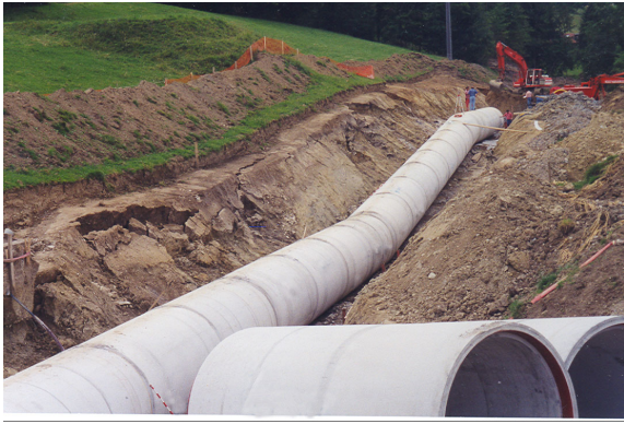
Figure 2 : Conduite d'adduction d'eau
