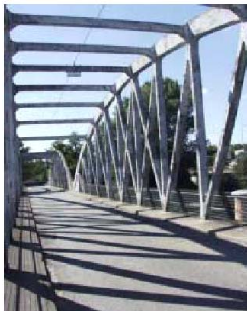
Figure 1. Pont d'Empalot (31). La circulation sur cet ouvrage vieillissant est réduite, pour des raisons de sécurité. Mais quelle est la marge effective de sécurité de cet ouvrage ?
