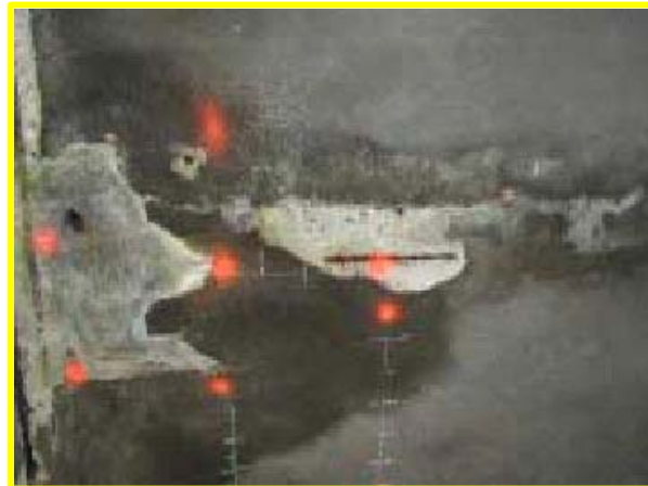
Figure 3. Intrados du tablier du pont d'Empalot (traces d'humidité, de corrosion, de fissuration) : comment évaluer l'ouvrage ?
