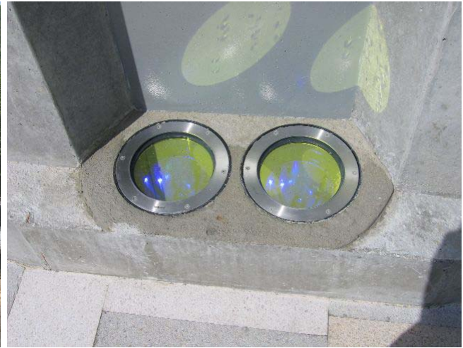
Figure 15 Projecteurs en pied de pylône
