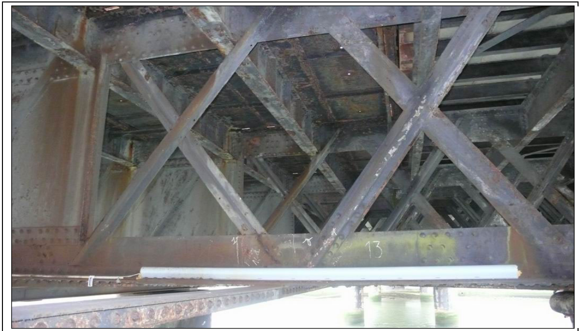
Pièce de pont n° 13 de la travée 2, fibre optique avec sa protection
