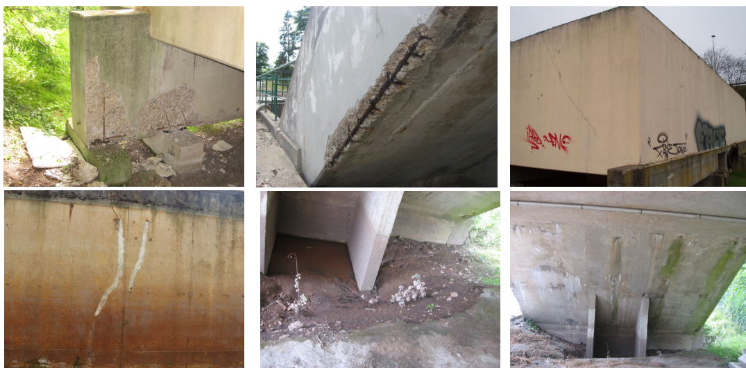
Photographies de défauts-type : aciers apparents oxydés, fissures, ravinements
