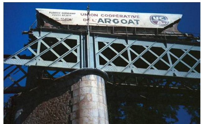
Effet d'un déraillement sur un tablier en fer puddlé (Pont sur la Baise)
