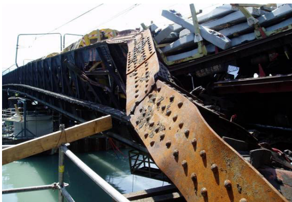
Déraillement sur le pont de Culoz en 2006
