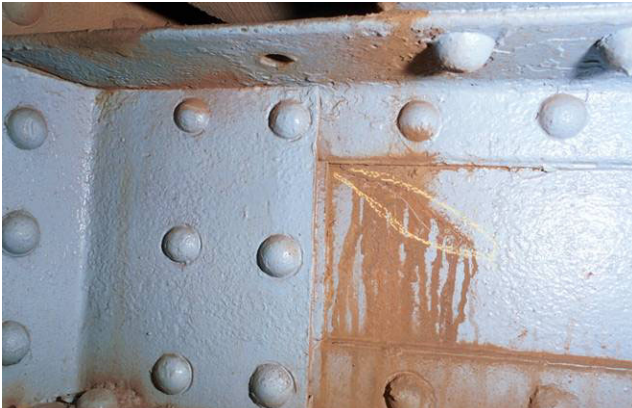
Exemple de fissure de fatigue
