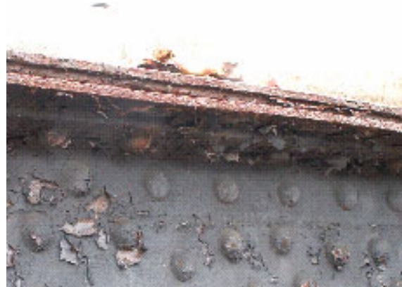
Exemple de corrosion de semelle
