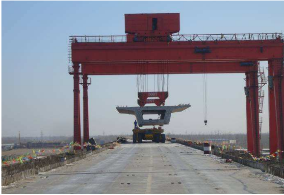
Figure 10 – Hissage de l'élément préfabriqué sur le tablier du pont Hoisting of precast unit onto bridge deck
