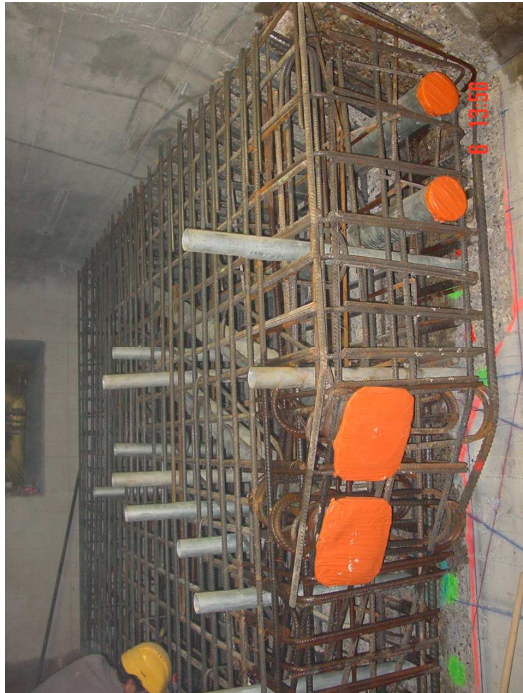
Photo 16 : Caisson aval, bossage B3 amont, densité de ferrailage 220 kg/m 3
