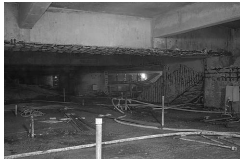
Figure 12 : béton de confinement à la cote + 7,5 NGM avec attentes pour mise en place du coulis d'injection au niveau des enrochements au contact du terrain
