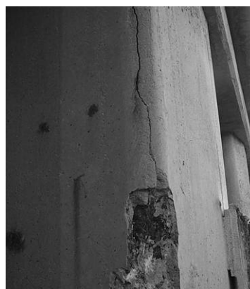
Figure 5 : détail de la fissuration et de l'épaufrure d'un poteau « peigne » brise houle, en zone de marnage
