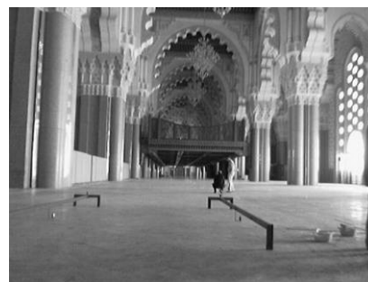
Figure 14 : surveillance de la dalle au sol de la salle des prières lors des injections de clavage sous-jaçantes
