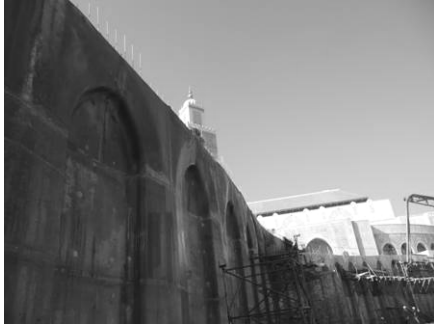
Figure 19: reconstruction d'un voile avec motif des peignes brises houles en BHP armé d'armatures inox sur la rampe d'accès à la dalle des pompiers
