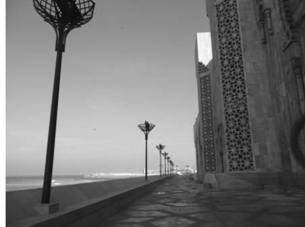
Figure 20 : reconstruction d'un bec brise lames et repose du revêtement en travertin et équipements
