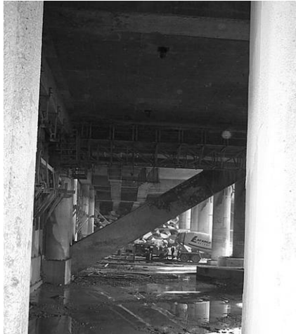
Figure 11 : mise en place du béton de confinement sous la salle des prières
