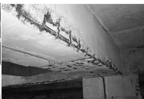
Figure 3 : épaufrures d'une poutre supportant la salle des prières, au contact avec les embruns marins
