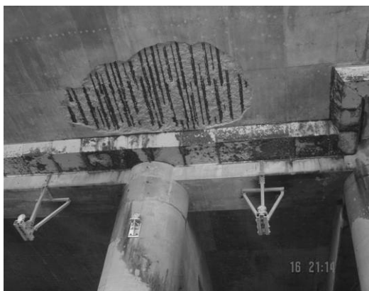
Figure 4 : vue d'épaufrures sous la dalle des pompiers, supportée par les peignes brises houle
