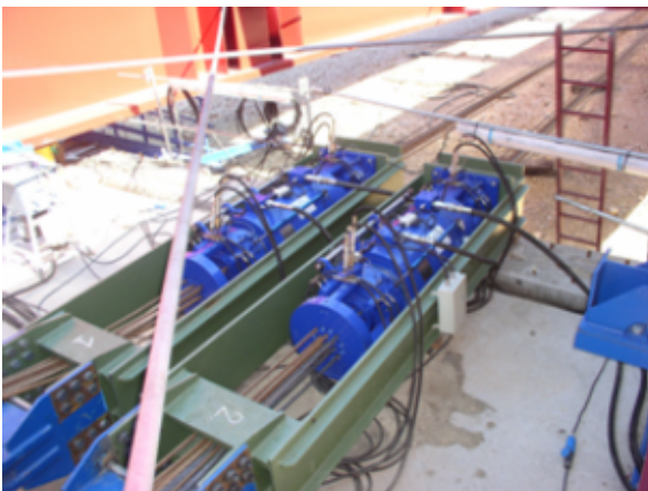
Vérins avaleur de câbles (V. Buyck)
