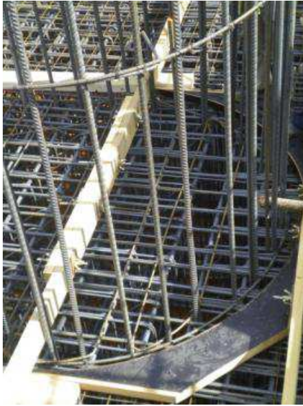
Talonnante en béton
