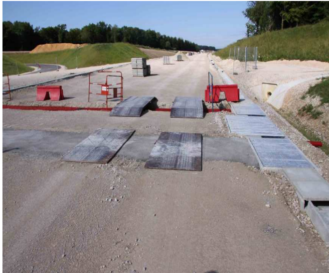
Artères câblées et traversées de voies
