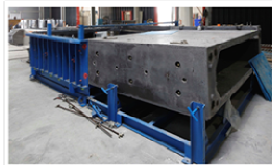
Photo 5 : Voussoir renforcé en position de conjugaison © H. Abbadie
