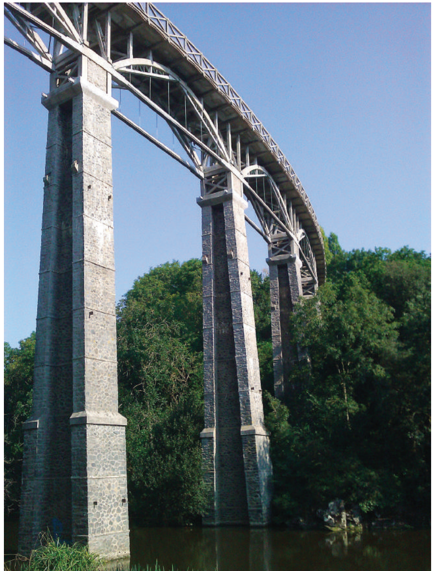
Figure 12 : Arc type caractéristique des ouvrages du second réseau des chemins de fer des Côtes-du-Nord. Viaduc des ponts Neufs sur le Gouessant entre Hillion et Morieux (22) réhabilité en 2014.
