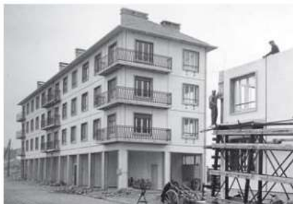
Immeubles en construction au sein de l'ilot N17 du Havre. Au premier plan des ouvriers entraînent de coffrer un poteau d'angle de l'ossature.
