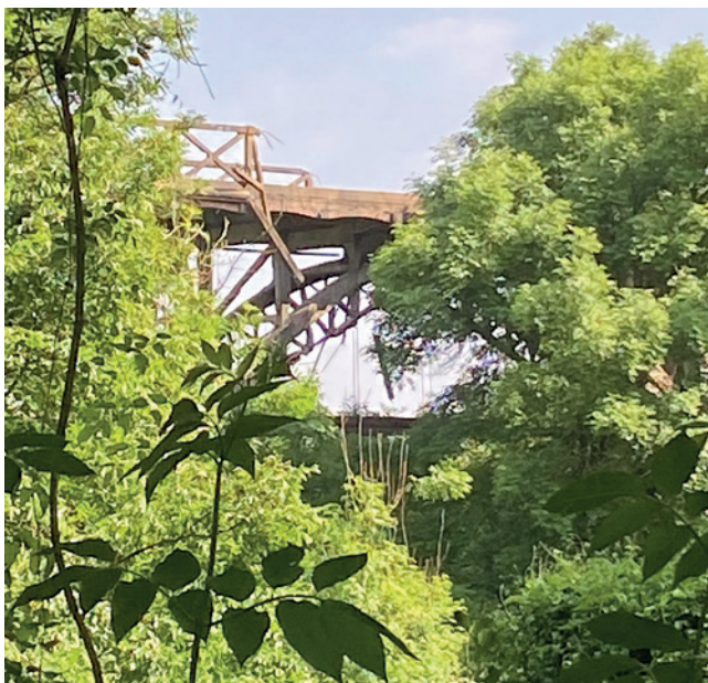
Viaduc de Port-Nieux à Fréhel et Plévenon (second réseau / ligne Yffiniac-Matignon) / L'ouvrage est abandonné au milieu de la nature, une restauration s'impose d'urgence © P. Guiraud
