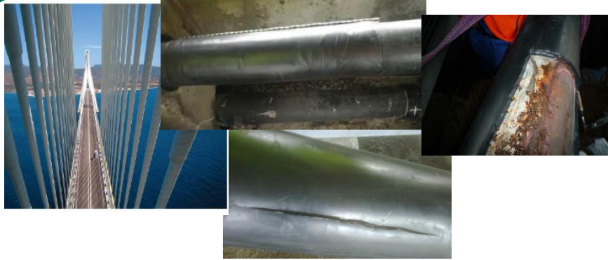
Gaines de précontrainte et de pont à haubans
