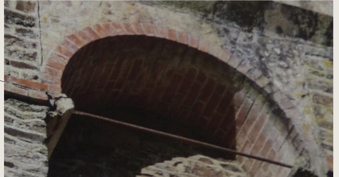
Fissuration de la base béton des voûtains briques de l'élévation des piles, juillet 2020
