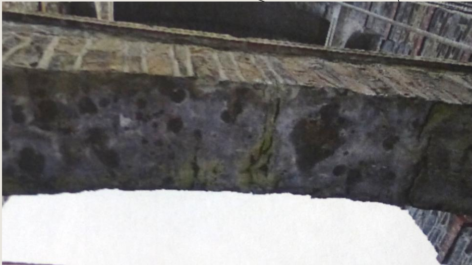
Fissuration transversale sous les contreventements Juillet 2020
