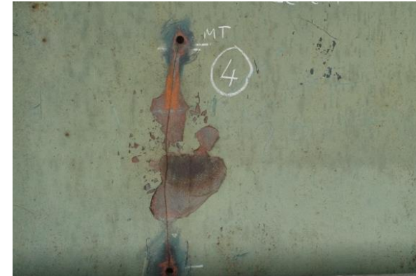
Fissure de fatigue, Frouard
