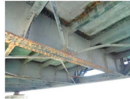
Déformation / Rupture de profilés
