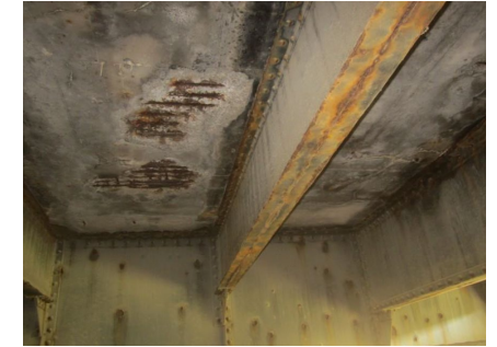
Aciers apparents corrodés en sous- face du tablier
